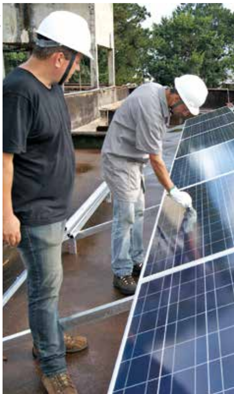
Painéis de energia fotovoltaica
