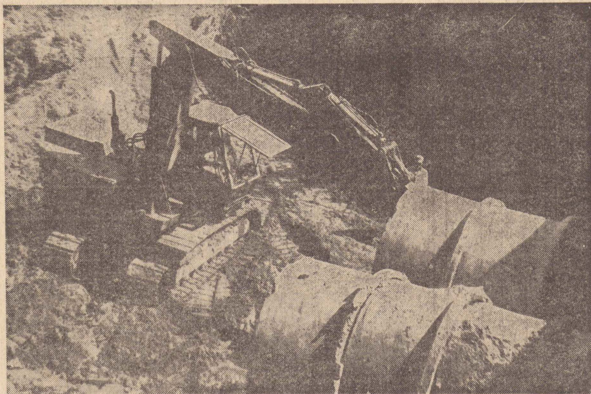
A violência da água levou até tubos de concreto, e a Prudente teve que construir uma nova rede
