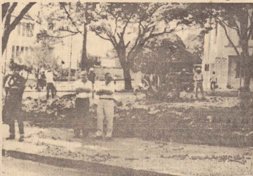
As reclamações contra o estado precário da praça Monsenhor Sarrion fizeram com que a Prefeitura iniciasse a remodelação.
