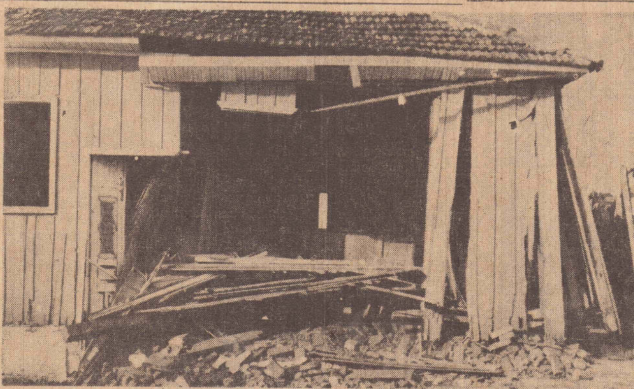
Toda a frente da residência foi destruída.
