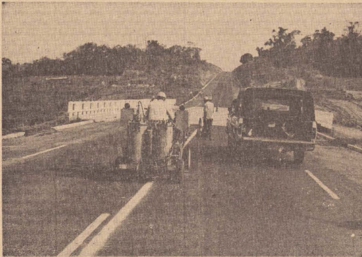
Inumeras rodovias do Estado de São Paulo, mudaram totalmente seu aspecto, após a reestruturação e recapeamento executados pela Encalzo S.A.
