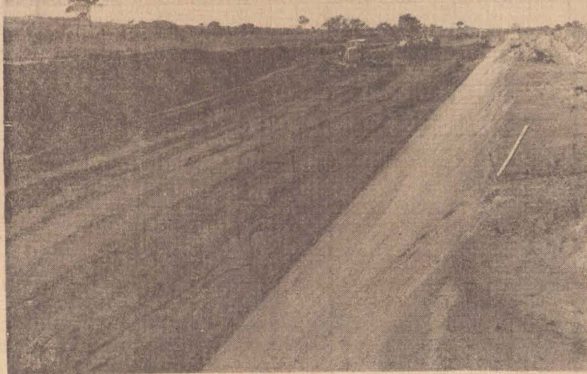
Este é um aspecto atual das obras do "Contorno" que ligará a SP-270 à SP-425, próximo ao Aeroporto.
