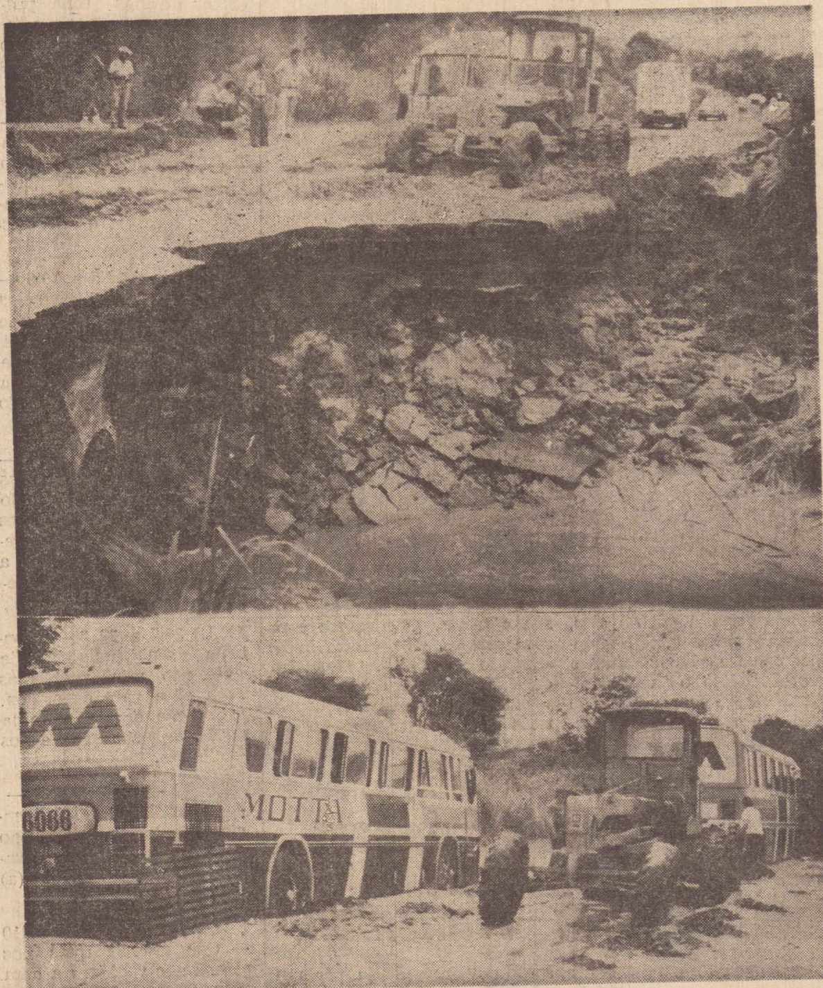
Em cima, a erosão que provocou a interdição de tráfego na altura do Km 523 da "Raposos Tavares". Em baixo, a situação em que ficaram dois ônibus da Viação Motta que seguiam à São Paulo
