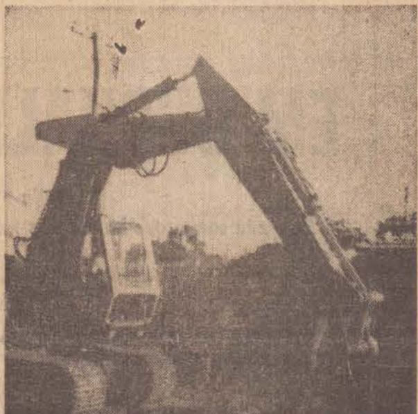
Retificando os correios e construindo emissários de esgotos. (F. Armando T. Otsuka)
