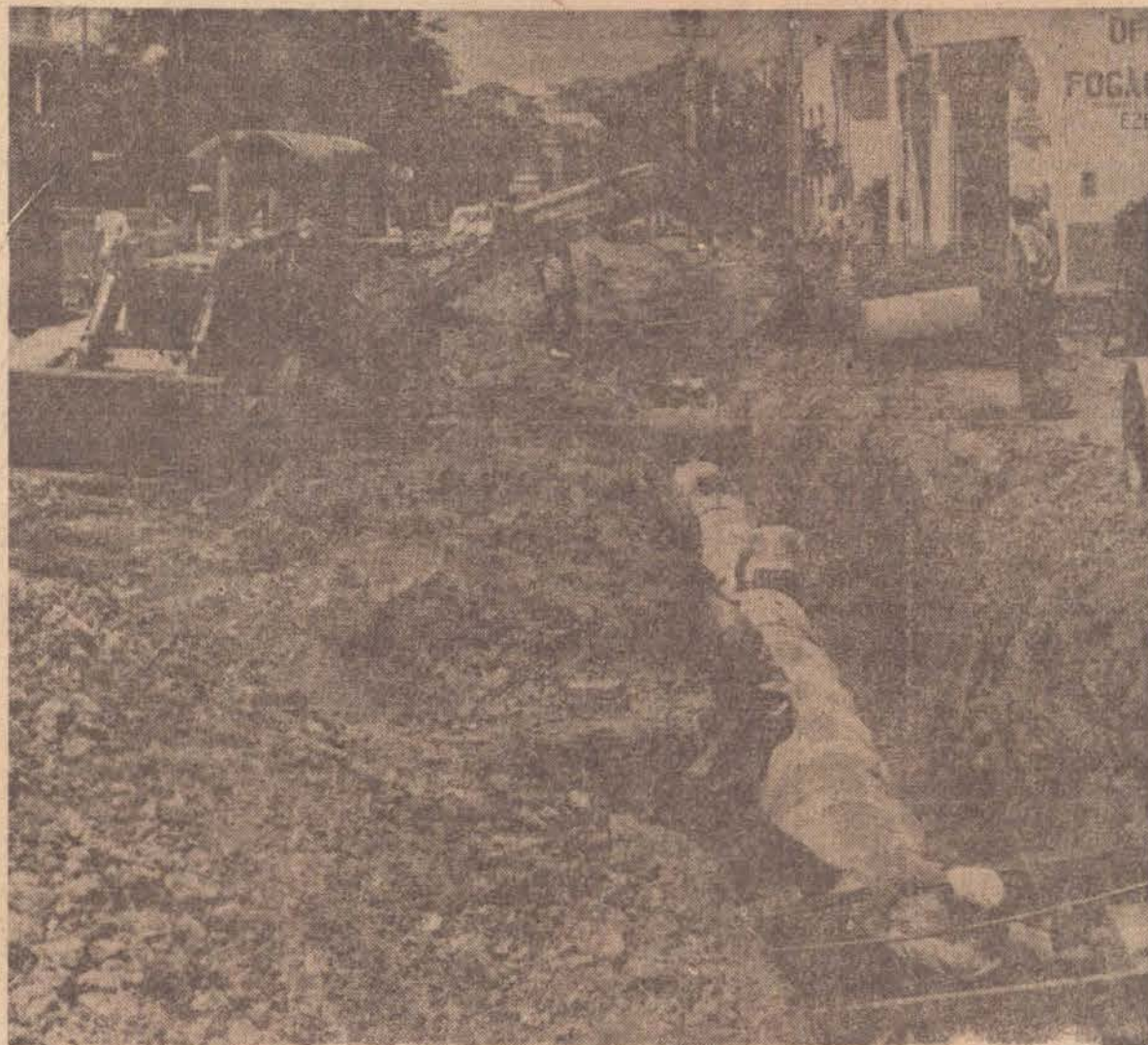
Para rebaixar o lençol d'água da rua Álvares Machado, a Prefeitura vai aplicar essas obras por valor de Cr$ 11 milhões.
