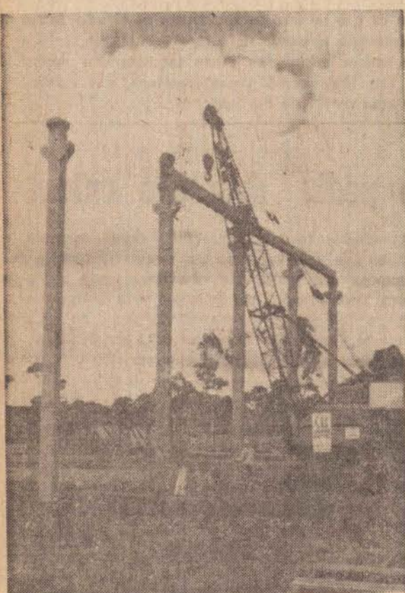
Fotografia da montagem dos pré-moldados, aparecendo na foto, o guincho montando as vigas calhas.
