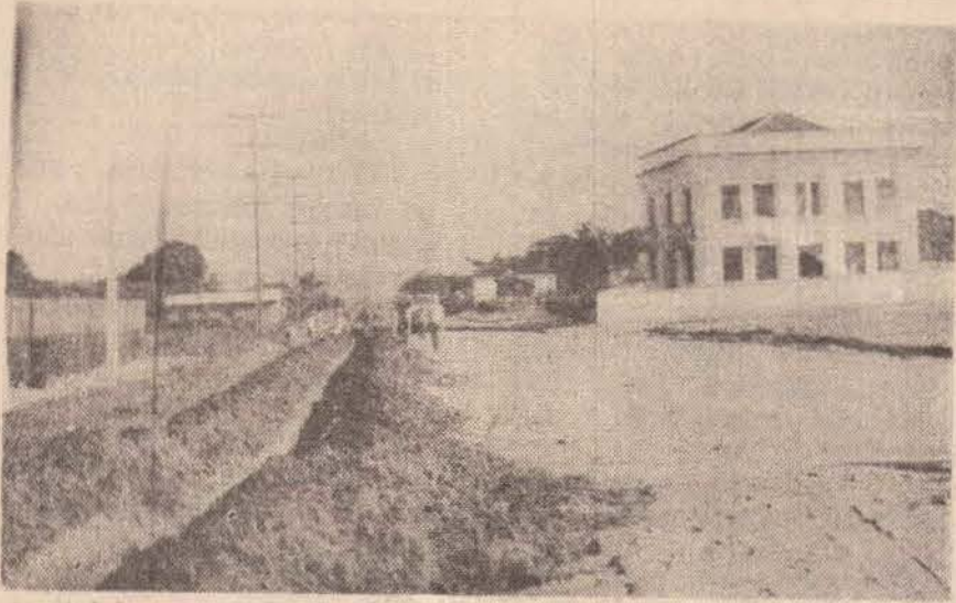
A rede de Água e Esgoto estendida nas ruas Julio Mesquita e Fernao Saltes, a qual ficará sob o asfalto a ser construído.
