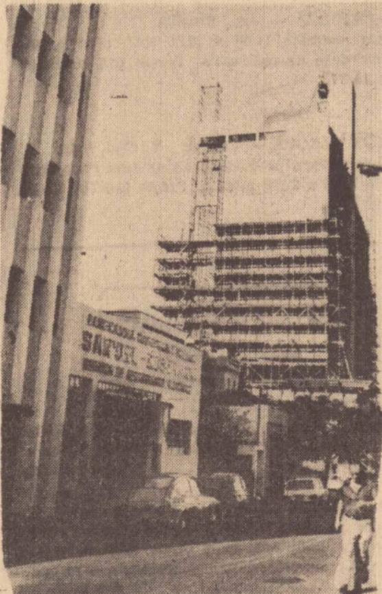
O edifício sede em Pres. Prudente, com 7 pavimentos serão concentrados todos os equipamentos da Central Automática, com 40 mil terminais.
