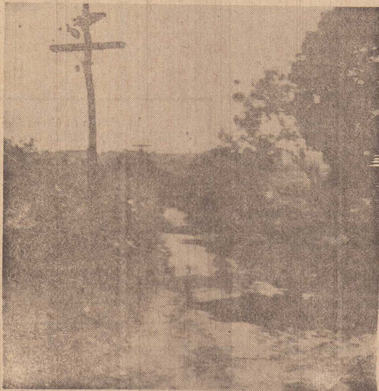
A rua Antonio Onofre Gerbas é um exemplo da situação geral das ruas do Jardim das Rosas.
