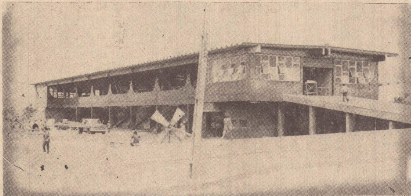
A nova estação rodoviária recebia ontem os últimos retoques para sua inauguração hoje de manhã.
