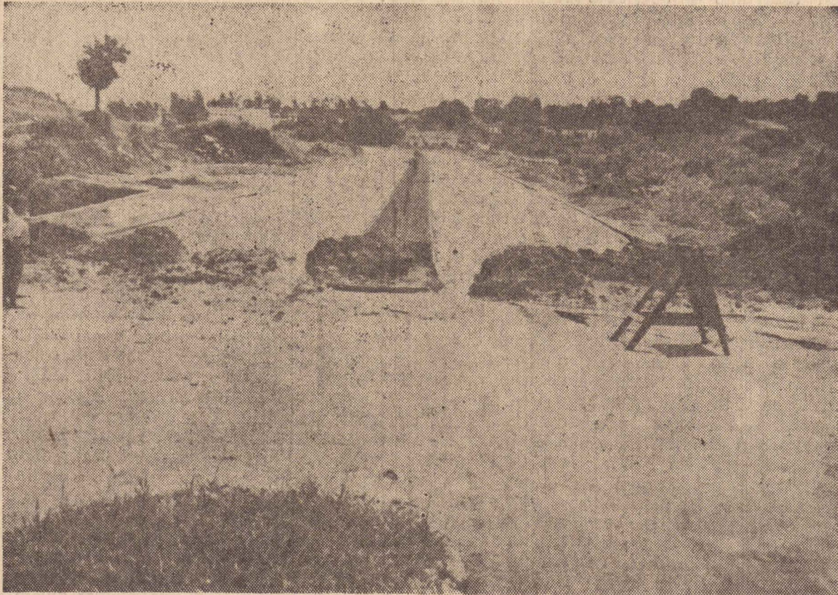
Apesar de não existir nenhuma iluminação, apenas uma placa (já derrubada por crianças) foi colocada a um metro do obstáculo.
