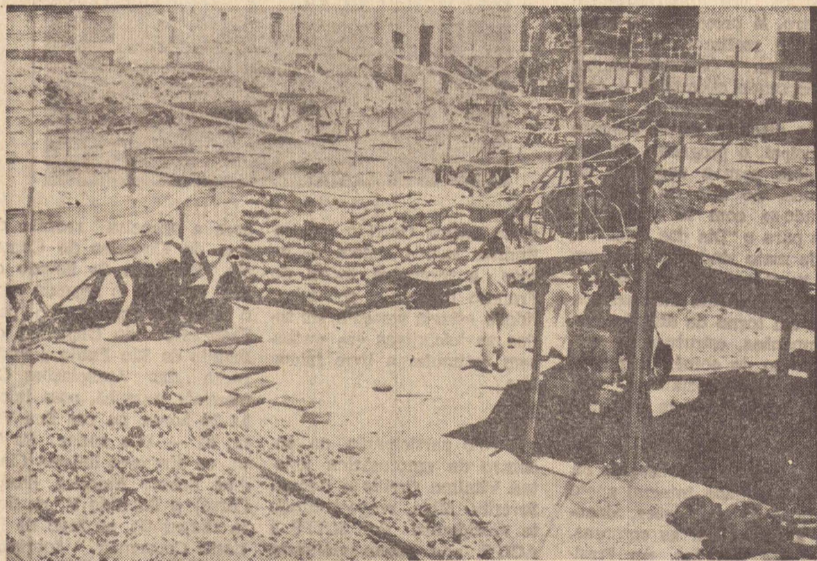
O tipo de solo está permitindo maior facilidade para o andamento das obras
