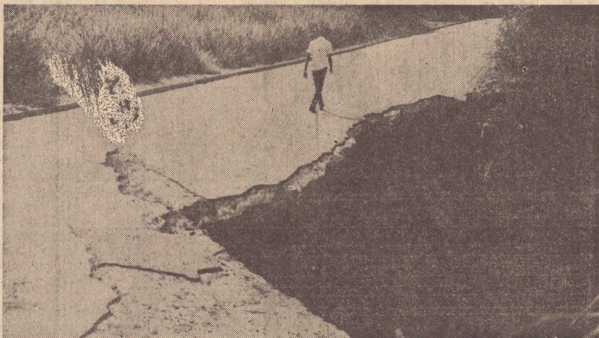
A erosão está consumindo a rua Alvino Gomes Teixeira
