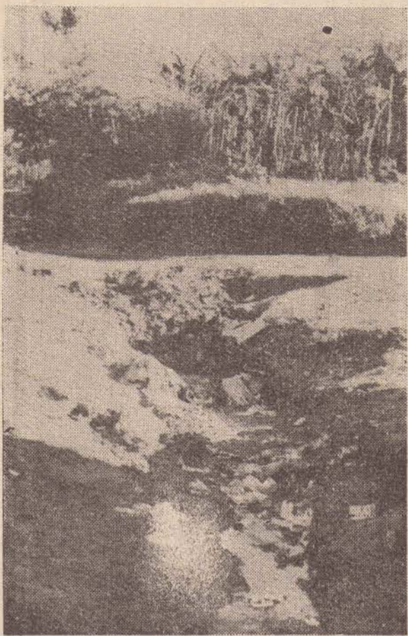
Uma das valetas no cruzamento das ruas Dario Machado de Campos e Daniel Martins
