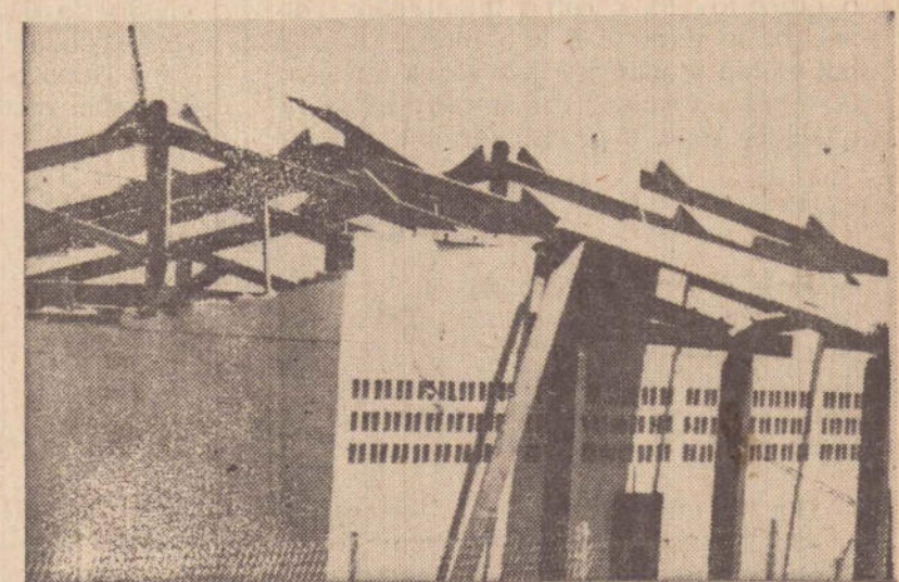
No Distrito de Nantes, o prédio da Escola Estadual de 1.º grau, foi o mais atingido pelo temporal.
