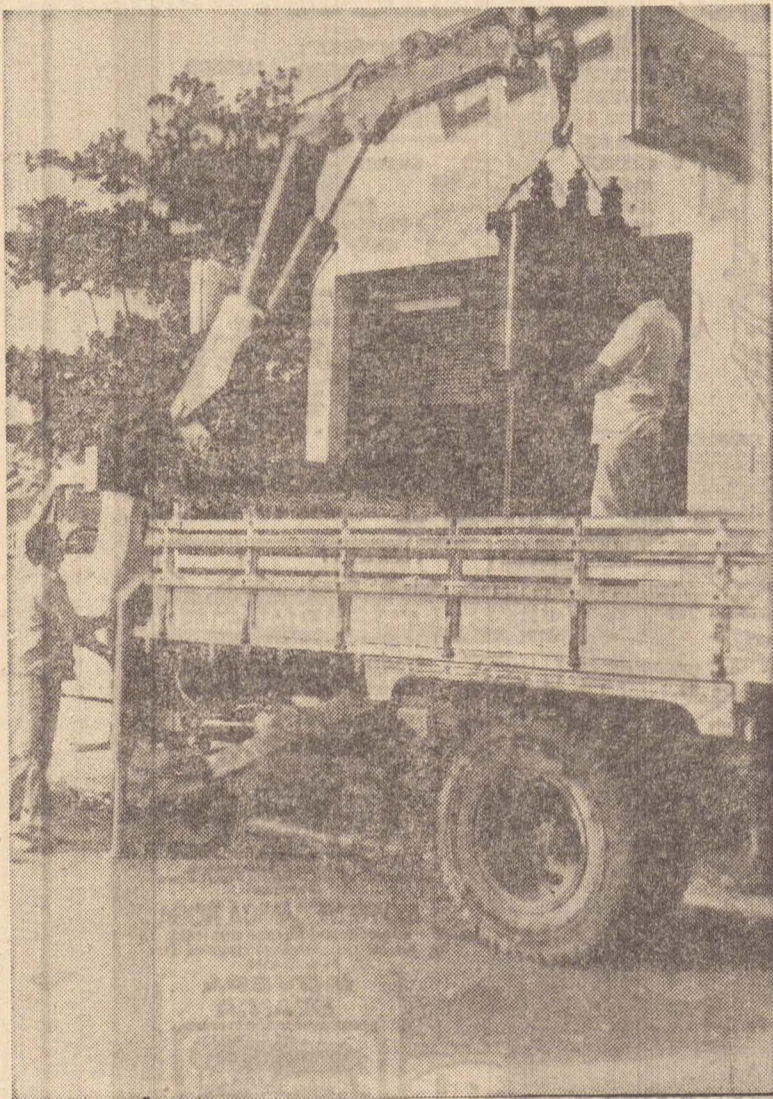
Em operação com um transformador, o caminhão Munk da Eletro Técnica Universo
