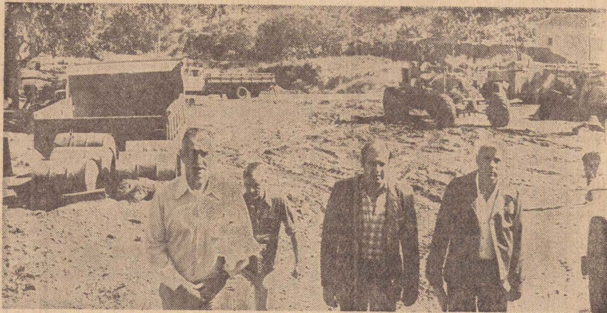
O prefeito visitando as obras ao lado do presidente da Prudencio e do engenheiro Sérgio Mele.
