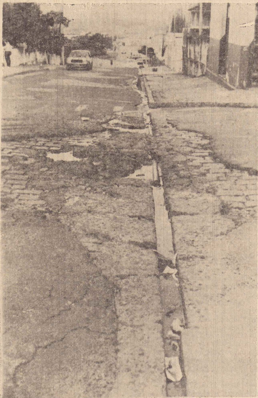
As fossas estouram e o esgoto corre a céu aberto
