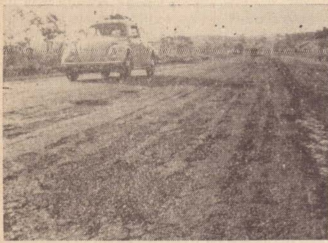
Depressões e buracos na pista dificultam o tráfego e oferecem perigo aos que transitam na Raposo Tavares entre Pres. Prudente e Presidente Epitácio.
