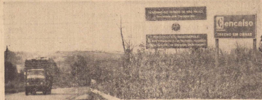
Aqui começa a SP-425, cujo trecho está recebendo melhoramentos e recapamento, sob a responsabilidade da ENCALSO — Engenharia e Construção Alta Sorocabana Ltda.
