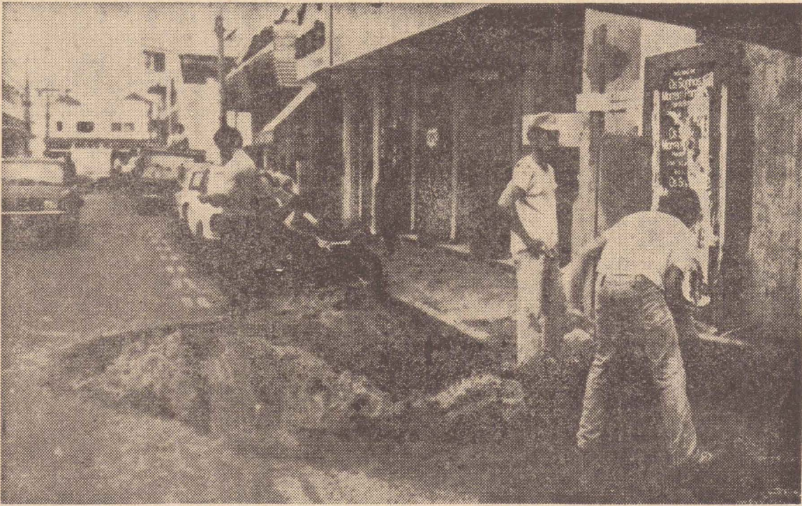
Os responsáveis pela obra devem tomar providências
