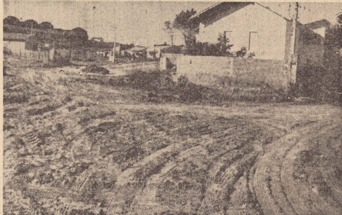
Neste local foi construída a galeria de 183 metros, possibilitando o trânsito de veículos e condições de pavimentar a rua
