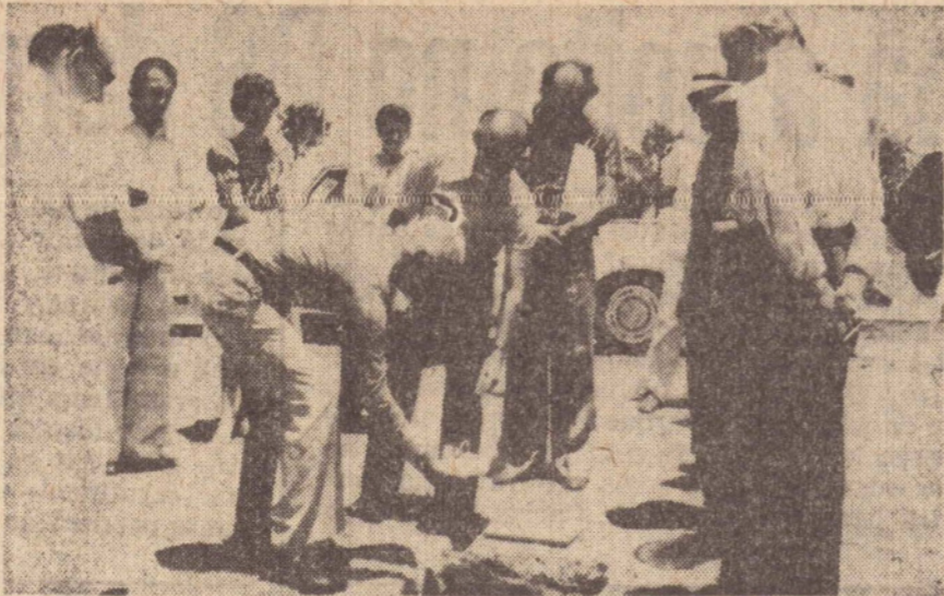
Na foto, momento em que o Dr. Clovis Carapeba, colocava documentos na urna do lançamento da pedra fundamental da Casa do Médico, sendo-se outros colegas e o casal Dr. Walter Lemes Soares (ela Ana Maria)
