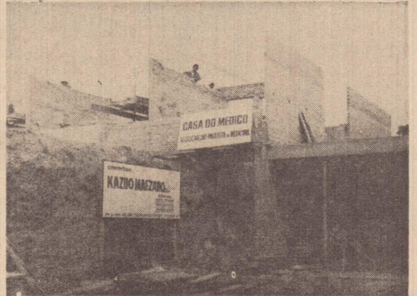
A Casa do Médico, da Associação Paulista de Medicina é outra obra em execução pela Construtora Kazuo Maezano.
