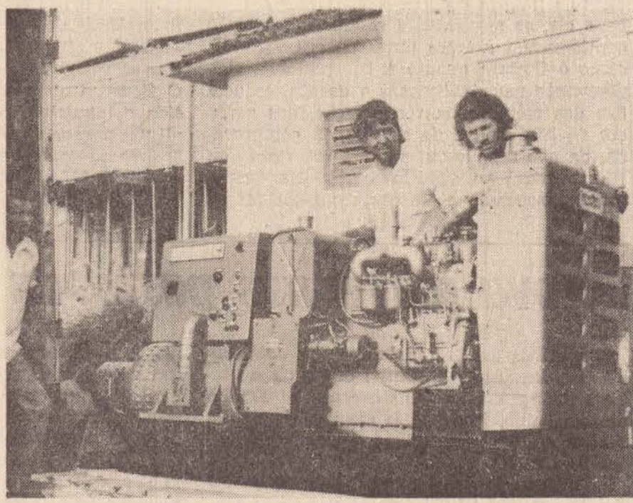
Grupo de geradores para fornecer energia no hospital — Motor HTB de 45 KWA-60 HZ — 220/127 Volts, trifásico com quadro de comando convencional.
