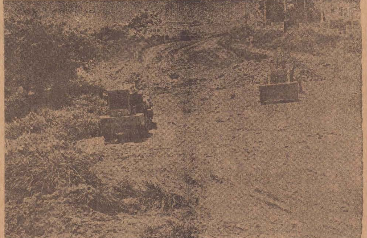
Preparação da área onde serão construídas quadras de futebol de salão e instalados equipamentos diversos.
