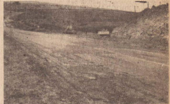
Neste local, o D.E.R. está executando uma variante a fim de possibilitar a construção definitiva de uma ponte de concreto na SP-270, junto ao trevo de Presidente Bernardes, evitando constantes acidentes que em 1971 vitimaram diversas pessoas.
