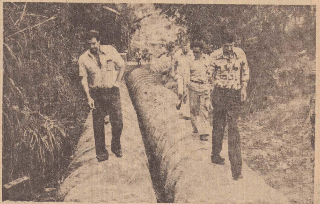
O prefeito pretende construir até o final de seu governo, 20 mil metros de galerias como essa..
