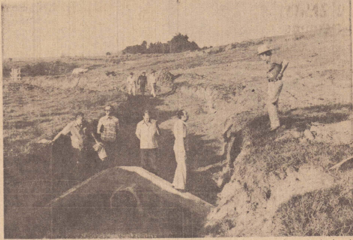
O sangradouro já construído e que dá vazão à água a mais de 150 metros de distância. A pista sobre o aterro terá 100 metros de largura ligando os municípios de Alvares Machado e Presidente Prudente.
