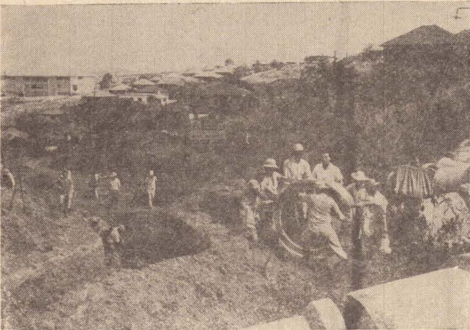
GALERIA DE AGUAS PLUVIAIS NA VILA MARINA
