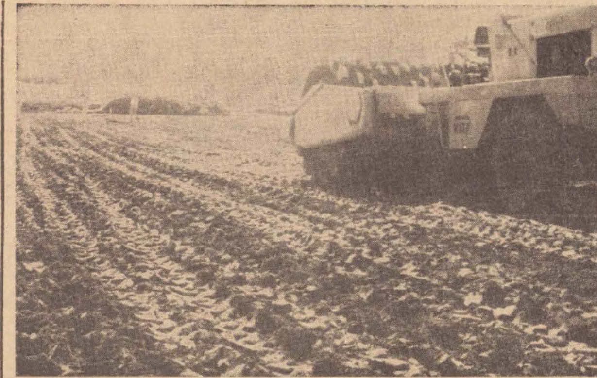
Estão adiantadas as obras de terraplenagem na ampliação de pisos do aeroporto prudentino
