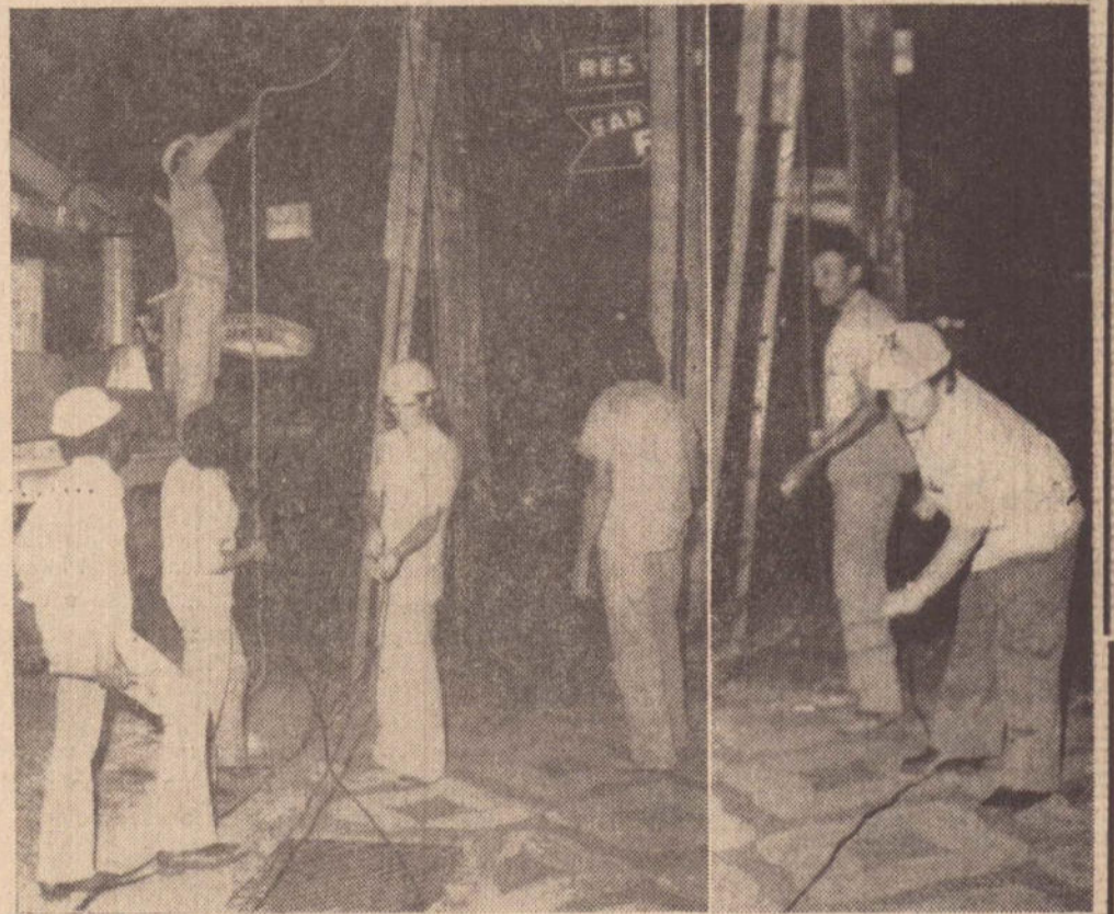
Na foto, a equipe da Caiuá trabalhando na colocação de um transformador provisório, vendo-se o Engenheiro João Carlos Relá
