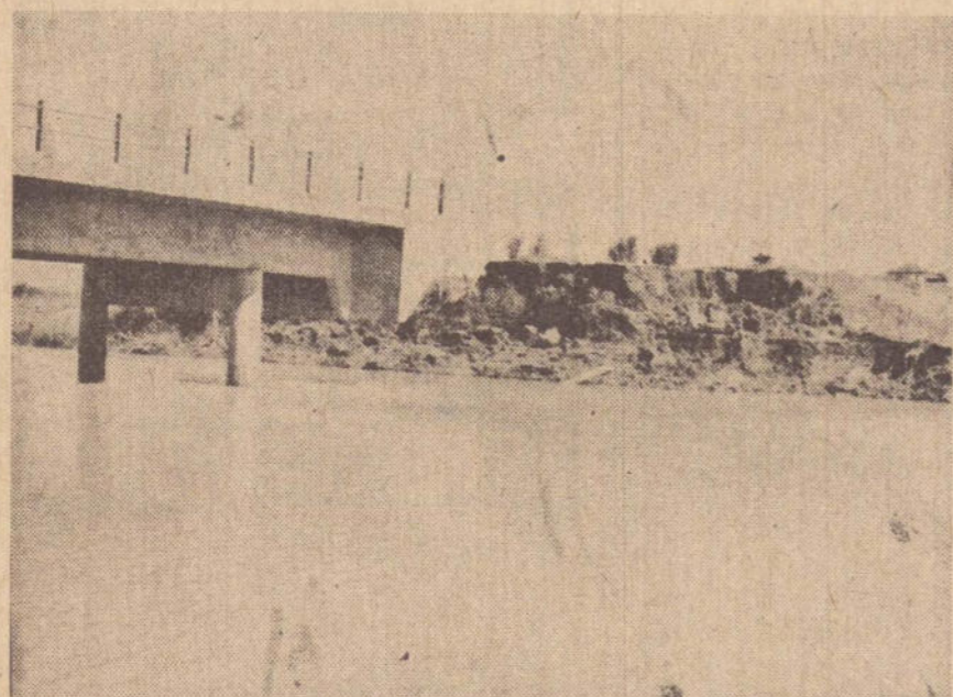
A ponte sobre o rio Anhumas onde caiu o aterro.
