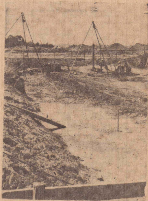
A reportagem fotografou os operários em atividades numa das fases inaugurais da obra. É a fase do estaqueamento do prédio destinado às oficinas.
