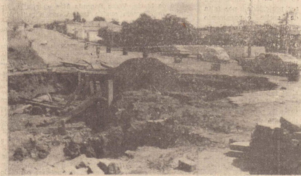
Na Avenida Tiradentes, no acesso à rodovia Raposo Tavares, as chuvas quase destruíram o leito carroçavel.
