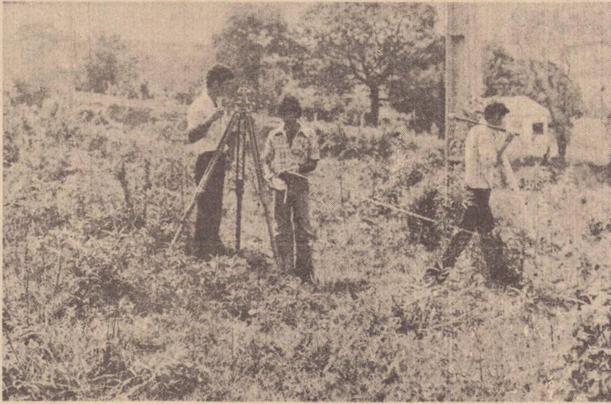
Engenheiros e servidores do Departamento de Obras da Prefeitura fazem a locação do novo trecho de estrada.
