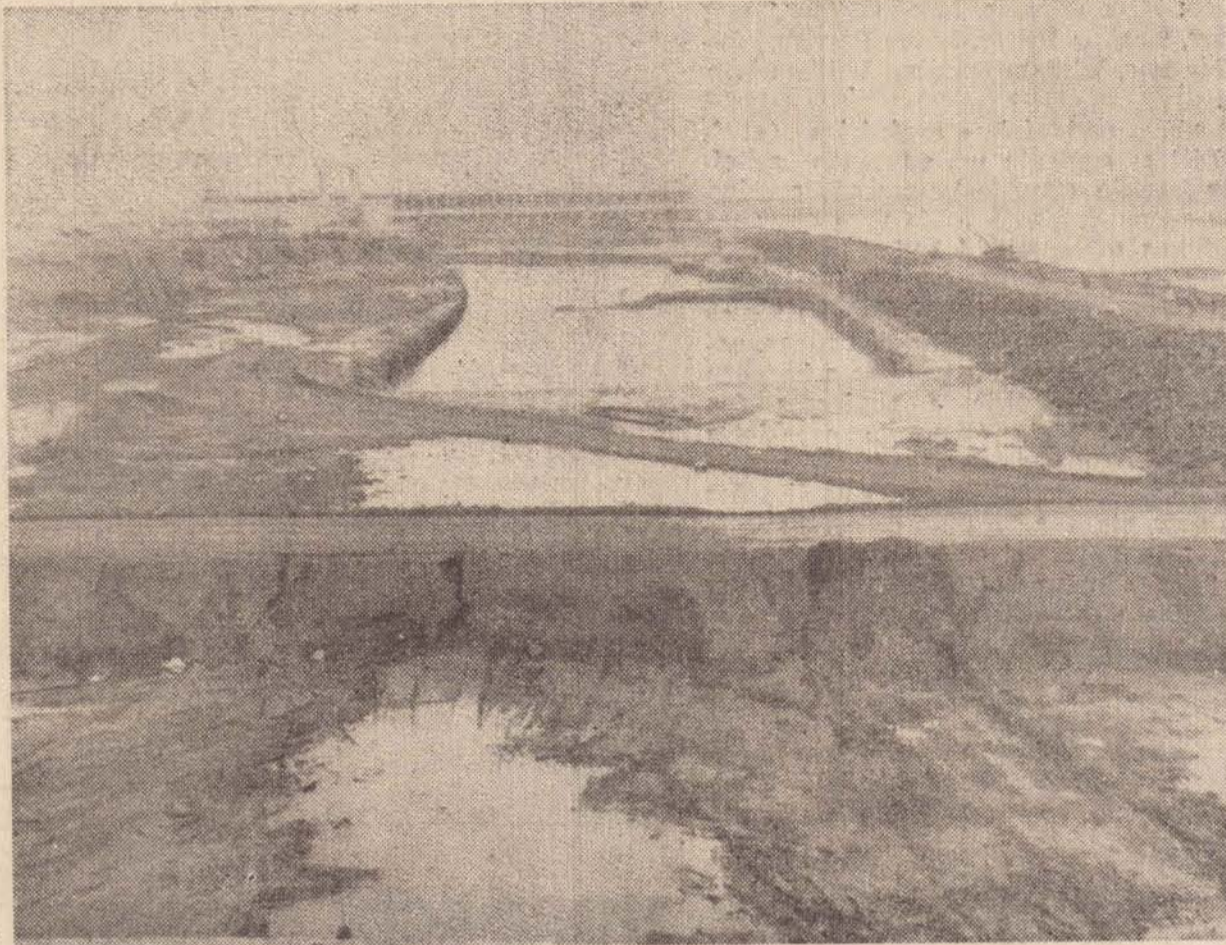
Pelos rios Paraná e Tietê, transpondo as barragens das hidrelétricas (pelas suas eclusas), será possível tornar os 1.400 km. daqueles rios inteiramente navegáveis. (na foto um trecho atualmente em construção).
