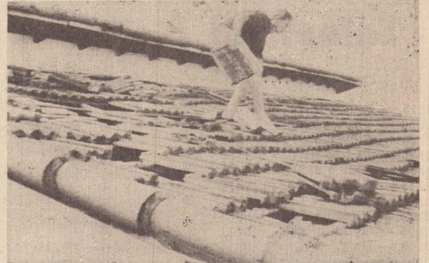
Depois do vendaval, a recuperação dos telhados danificados.
