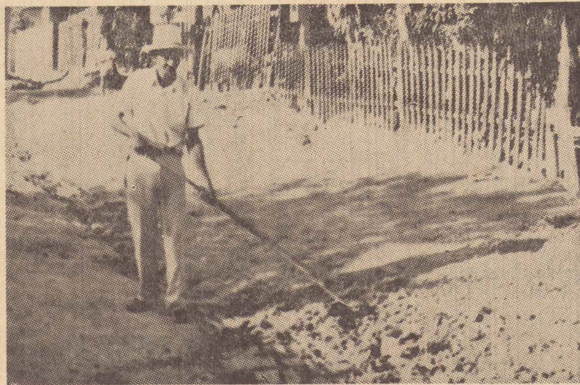
Sebastião Gomes tem que tapar os buracos se quiser manter conservada a Rua defronte sua casa
