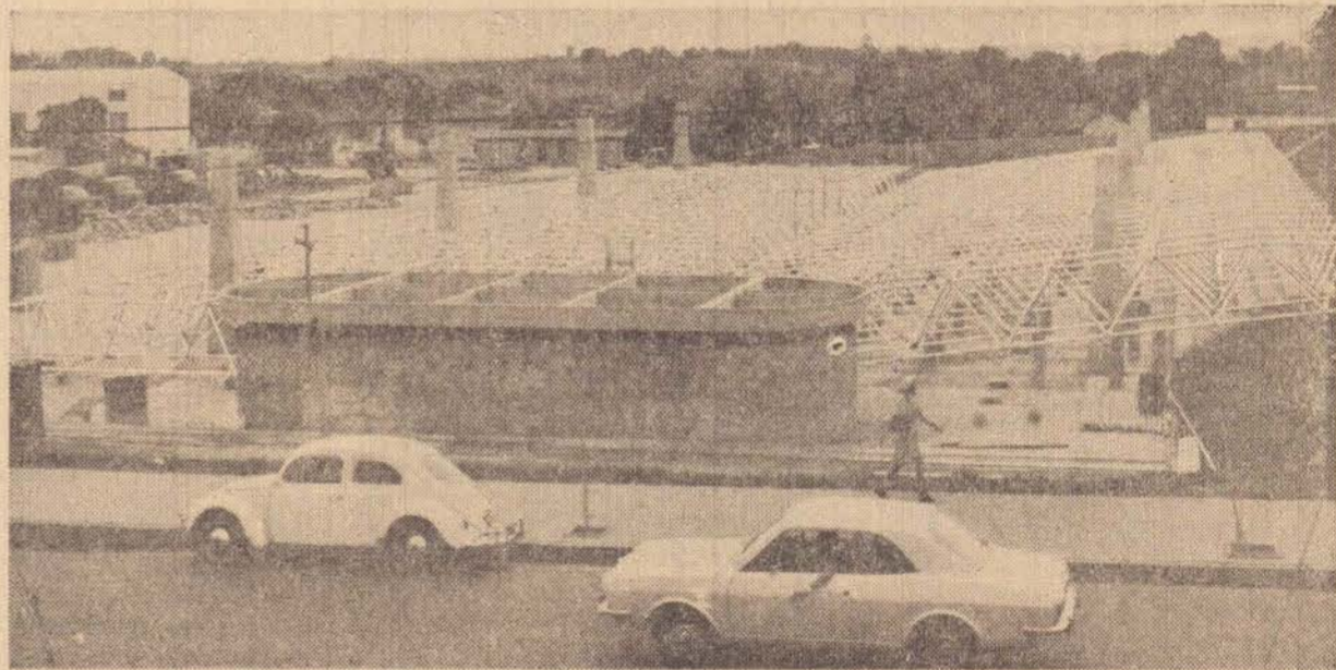
A cobertura do parque de uso múltiplo que já está sendo implantada.
