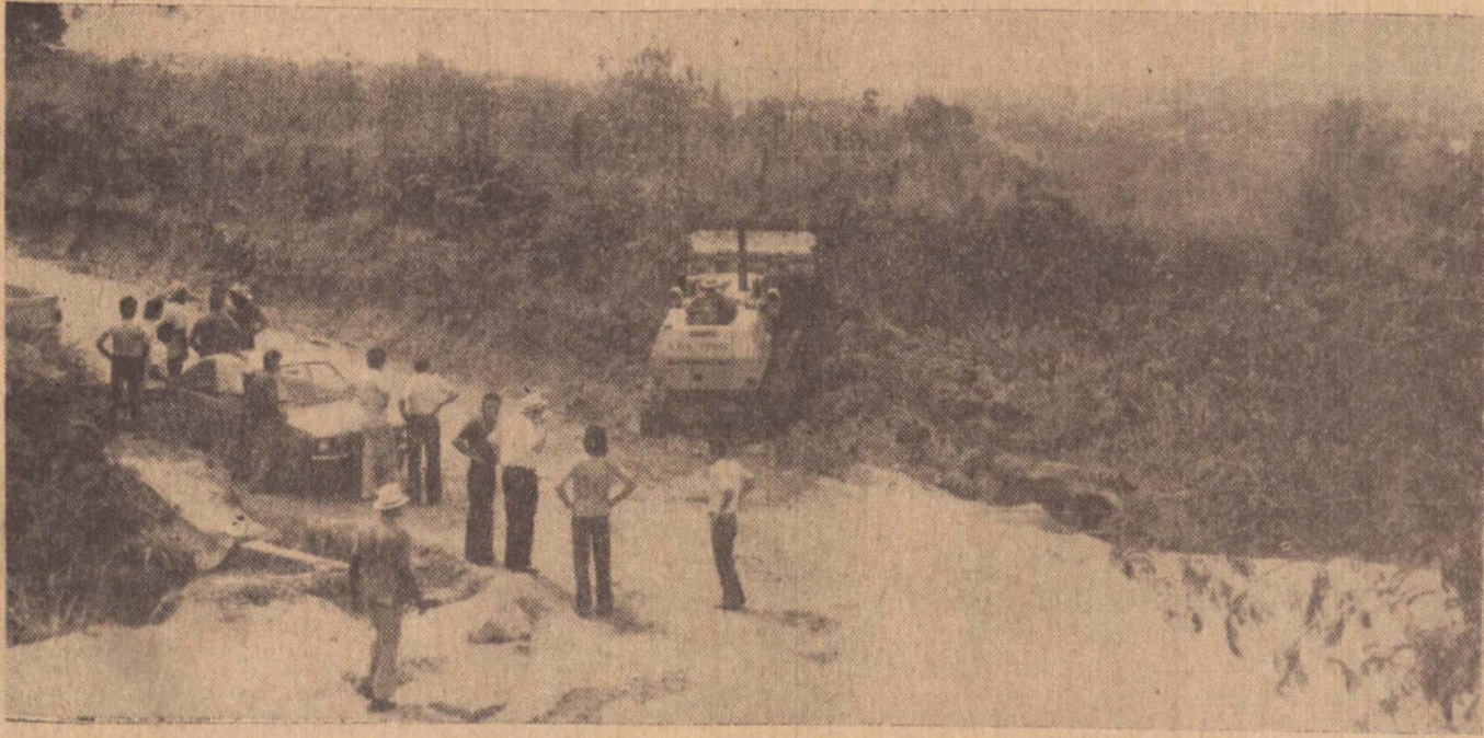
Exatamente nesse lugar iniciaram-se as obras de prolongamento da estrada Prudente-Alvares Machado até encontrar-se com a Avenida Washington Luiz, seguido de sua pavimentação.
