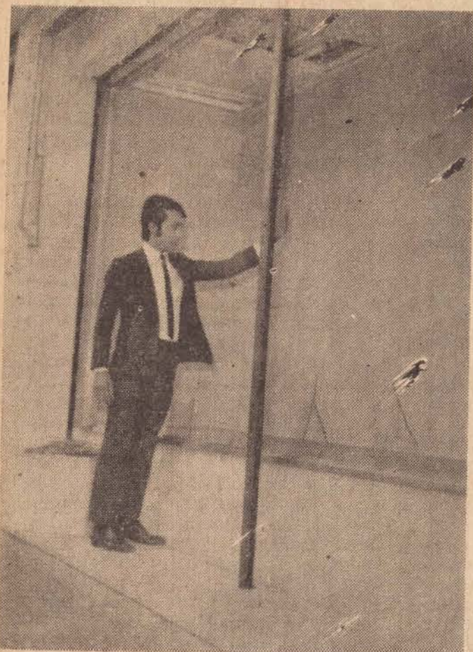
A foto de Florindo Orbolado mostra o estado em que ficou a vitrine da Rio Branco da Loja Duton. O funcionário daquela firma, Nelson Osti mostra ao reporter o estado em que ficou aquela vitrine, com os vidros transformados em amontoados de cacos.
