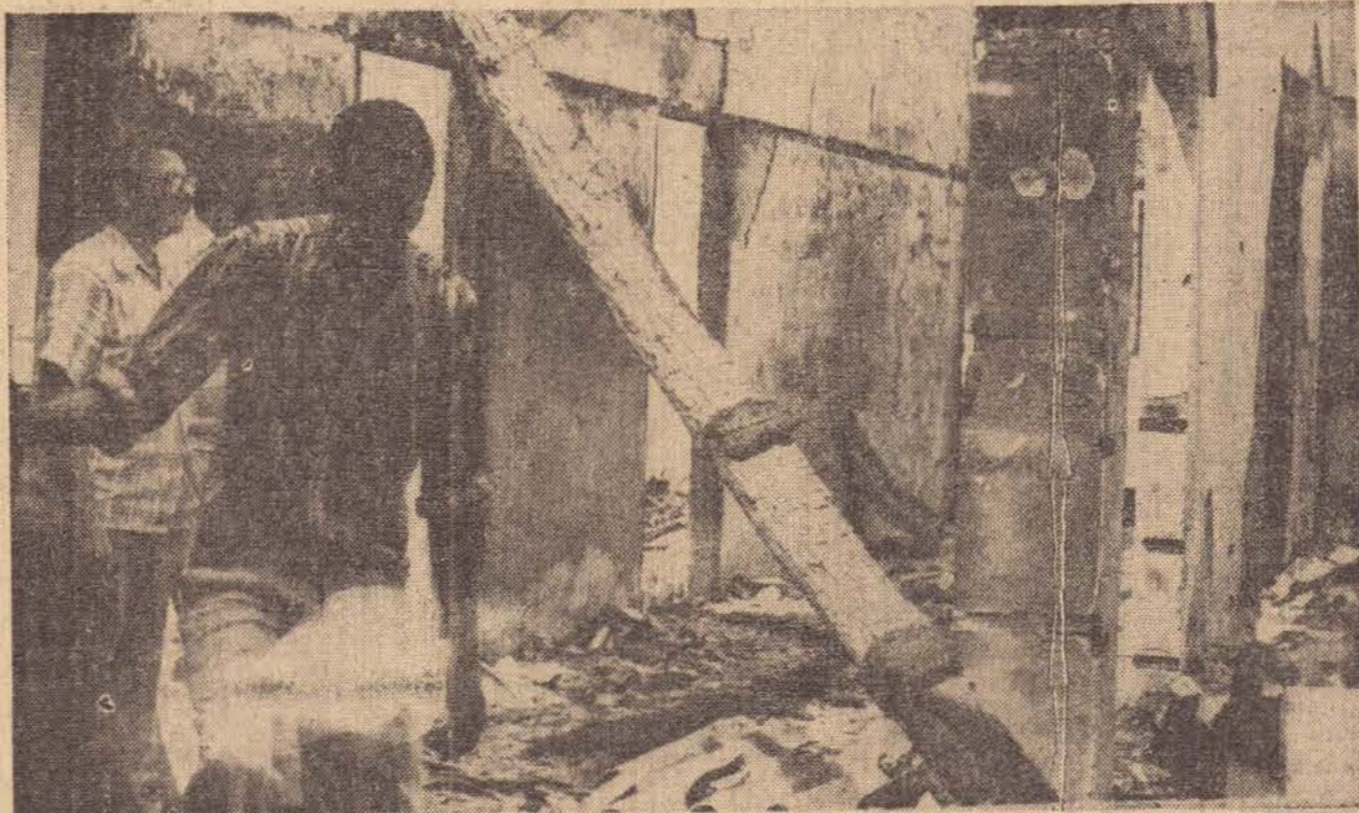
Aspecto de como ficou o prédio, após o incendio.
